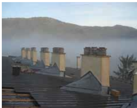
Conduits de cheminées
