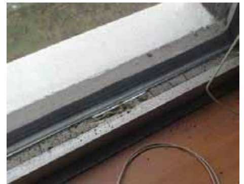
Joints de fenêtres
